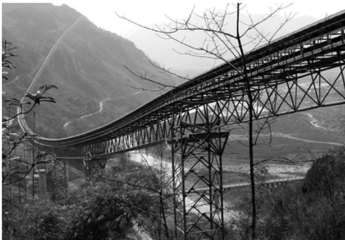
Hình 7. Băng tải có hướng tuyến không gian dạng cong, “BEUMER”, Đức, lắp đặt tại tỉnh Tír Xuyên, Trung Quốc
